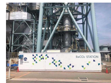
CO2回収デモ機 外観
